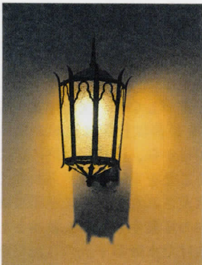
旧校舎のブラケット照明。パナソニック電気汐留ミュージアムの「ウィリアム・メレル・ヴォーリズ 恵みの居場所をつくる」展に貸し出すにあたり、修復していただきました
